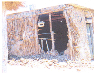
Durch Unwetter wurden die alten Lehmhütten so schwer beschädigt, dass sie unbewohnbar geworden sind.
