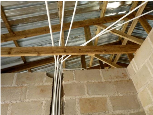
die elektrischen Leitungen sind installiert
