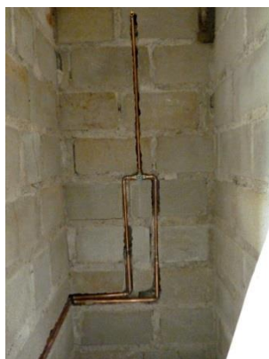
Kupferleitungen in der Toilette
